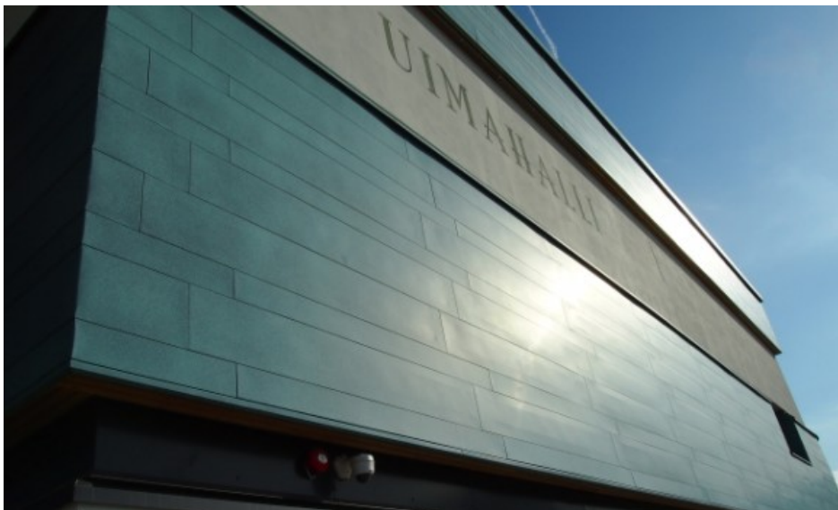
KUVA 9. Porin uimahallin julkisivun Nordic Solar -fasadikeräimiä. ( http://solarforum.fi/wp/wp-content/uploads/2014/06/swimhall-solar2-580x350.jpg )
