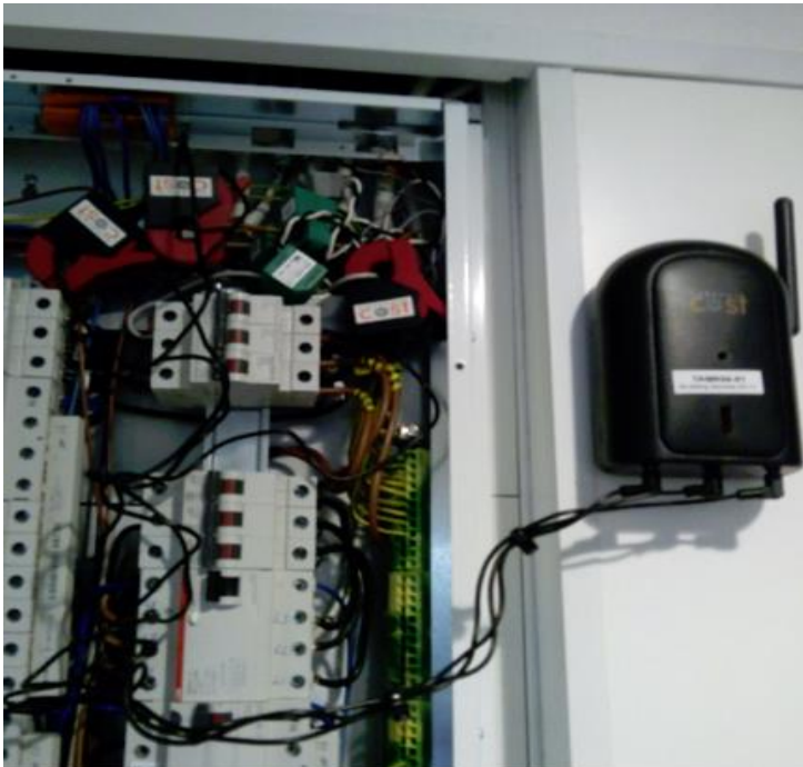
KUVA 3. Kohteen B keskuksen asennettu Current Costin mittalaite (Kuva: Matias Kosunen, 2014)
