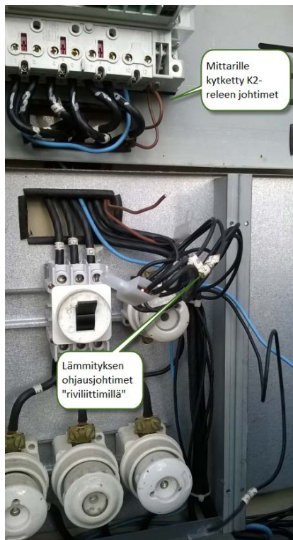
Kuva 3 Esimerkki AMR-mittarin asennuskytkennästä. Yö-aikaohjaus (K2) kytkettynä mittariin. Keskuksesta valmiina olevaa teho-ohjausta ei ole kytketty mittarin releen liittimiin.
